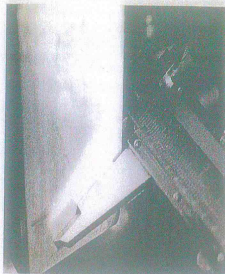
主开关出线母排厚度
